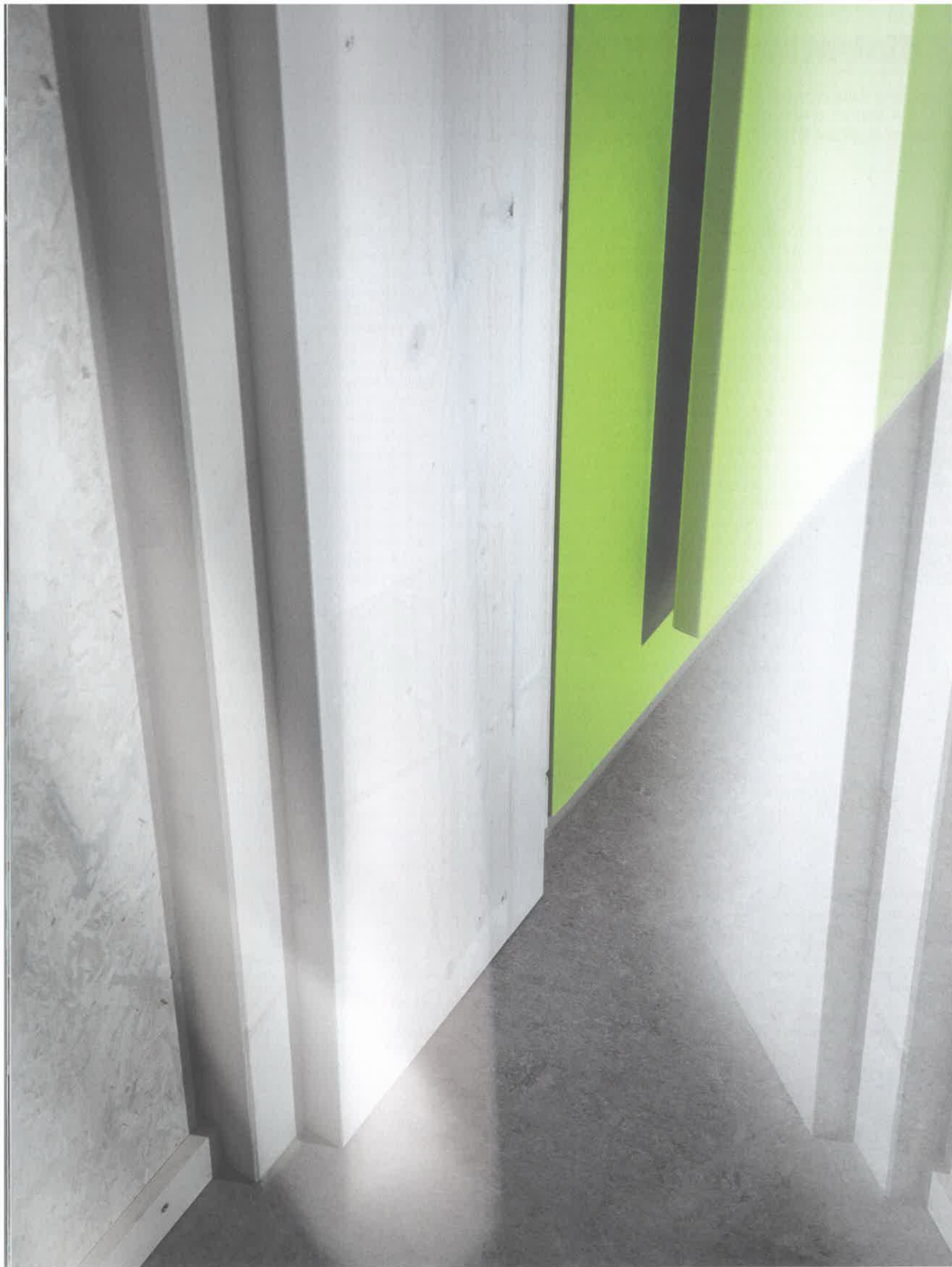
Kantonsschule Stadelhofen, Filiale Dübendorf: In der unteren Hälfte der Verbundlüfter strömt frische, kühlere Luft ins Klassenzimmer.
